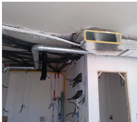
Ventilaciones y aire acondicionado
